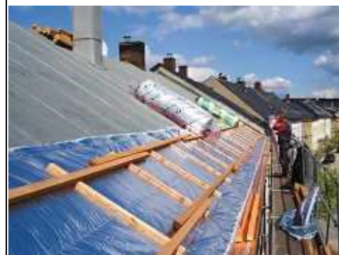
Wärmedämmfolie als Aufsparrendämmung, die mit ihrer IR-Reflexion Strahlungsverluste im Winter und Aufheizungen im Sommer verhindert. Bild: Gäbler Dachsysteme & Thermografie
